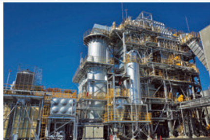
バイオマス発電プラント
