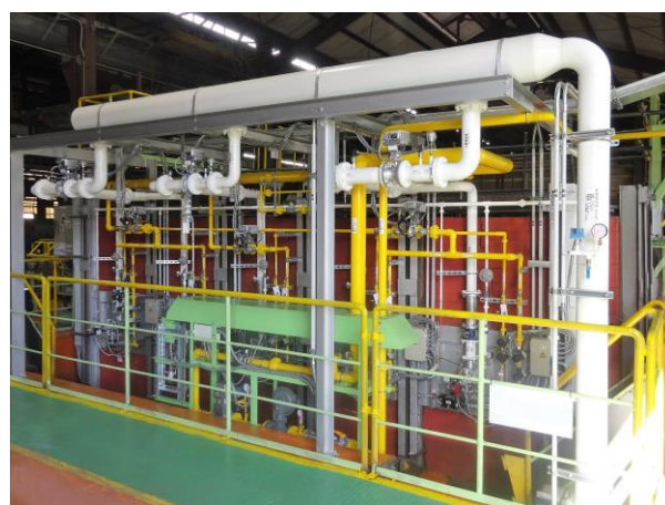
バーナを導入した鋼材熱処理炉（写真奥）と、 炉側面に組付けられたバーナ・配管（写真手前）
