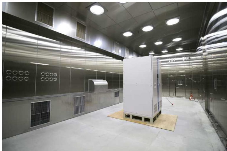
大型恒温恒湿室
