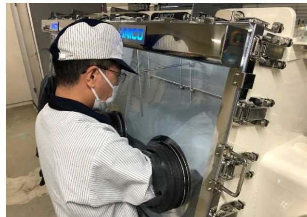
セル解体用グローブボックス
