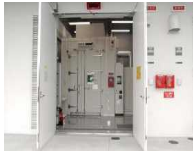
充放電試験用の恒温恒湿室
